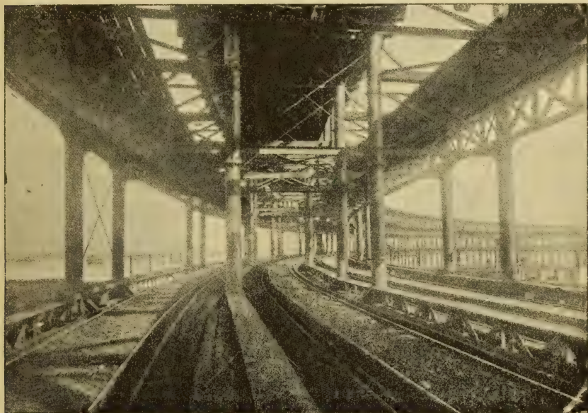
HUELVA.—PISO INTERMEDIO DEL MUELLE DE HIERRO DE LA CÔMPAÑIA MINERA DE RÍO-TINTO
